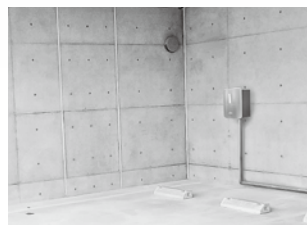
充電設備の設置イメージ
