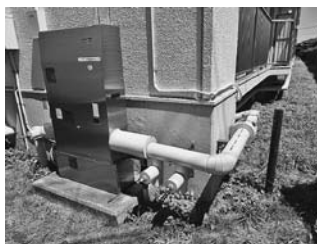
2019年、増圧ポンプから全棟16系統の立管までの給水埋設管を耐衝撃性の高いHIVP管に更新し、露出配管とした
